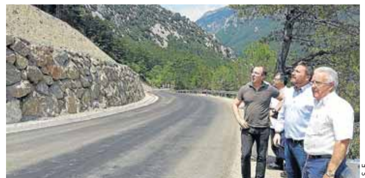
El consejero Soro durante su visita a las obras de emergencia de la A-2609, entre Salinas y Plan.
